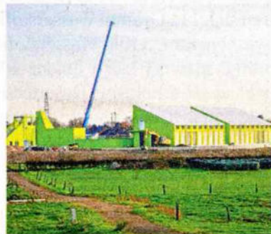
Es grünt so grün am „Sauberfluss“ Emscher: Das gilt selbst für die Fassade des Holtener Pumpwerks. RUPERT OBERHÄUSER/EGLV
